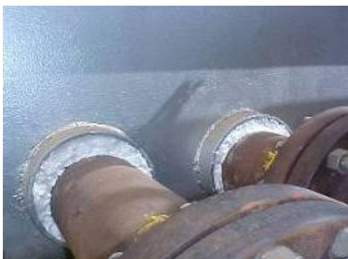
Vedação de entrada de "ar falso".
